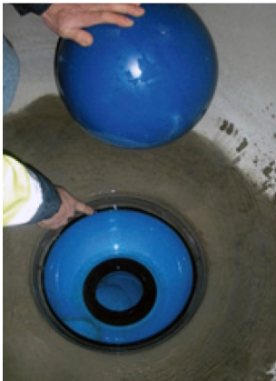
Visuell inspeksjon av øvre pakning evt. rengjøring nedenfor kula
