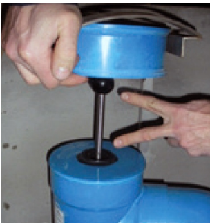
Manuell inspeksjon - flottøren
